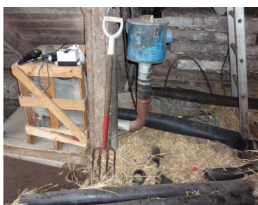
Kornblæser (i trækasse) tilsluttet gl. vandingslanger med huller i, som leder luften ind under komposteringsmåtten.
